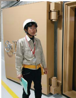
島根原子力発電所3号機建屋内の水密扉
