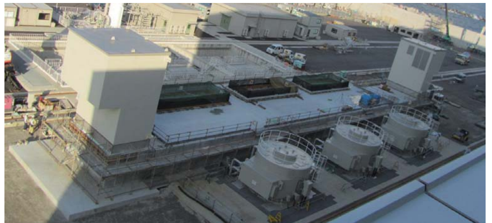
防水蓋で保護された海水ポンプエリア
