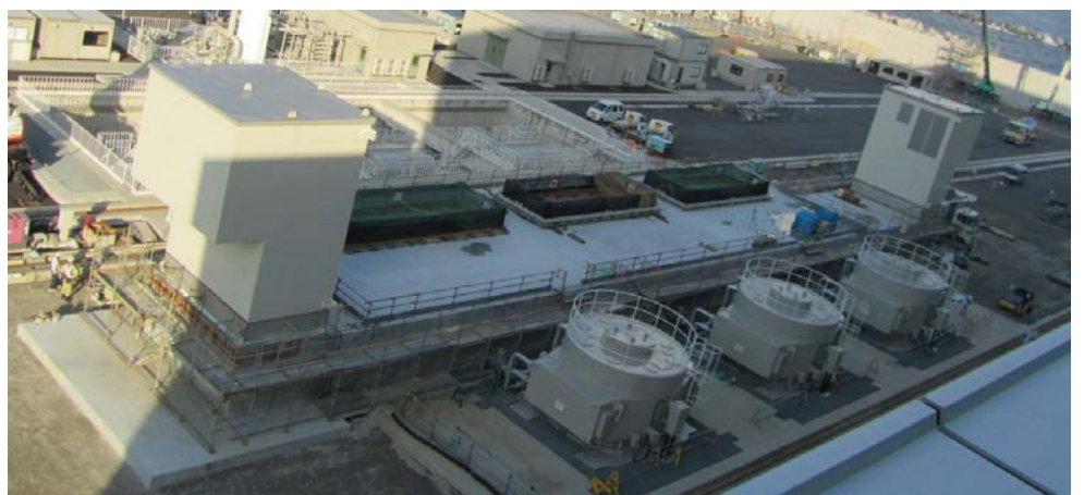
防水壁に囲まれた海水ポンプエリア
