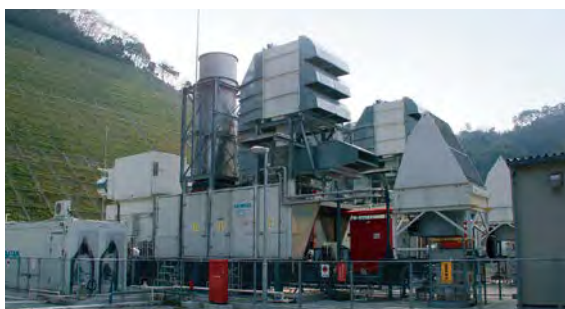
ガスタービン発電機(出力1万2千kW級×2)/1~3号機の冷却および、運転に必要な電源を1週間程度供給可能(海拔44m)
